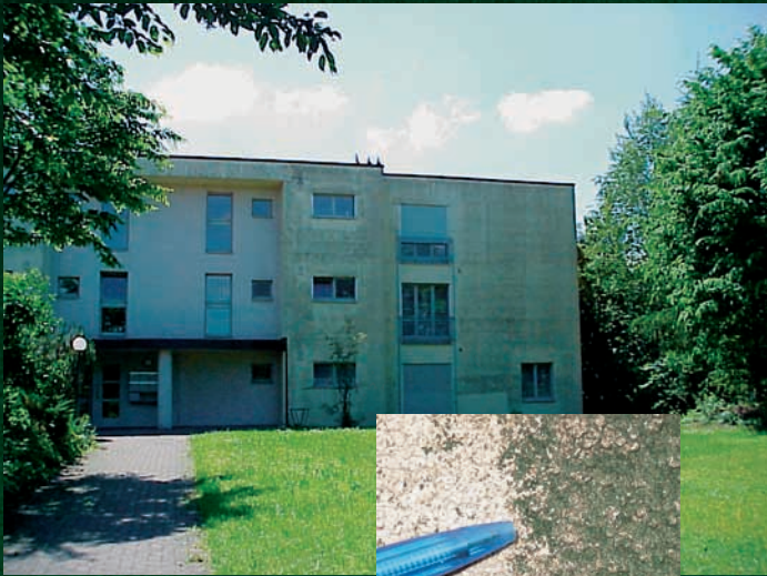
Algenbefall auf der Nordseite
