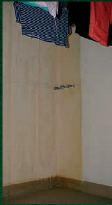
Pilzbefall in Waschküche
