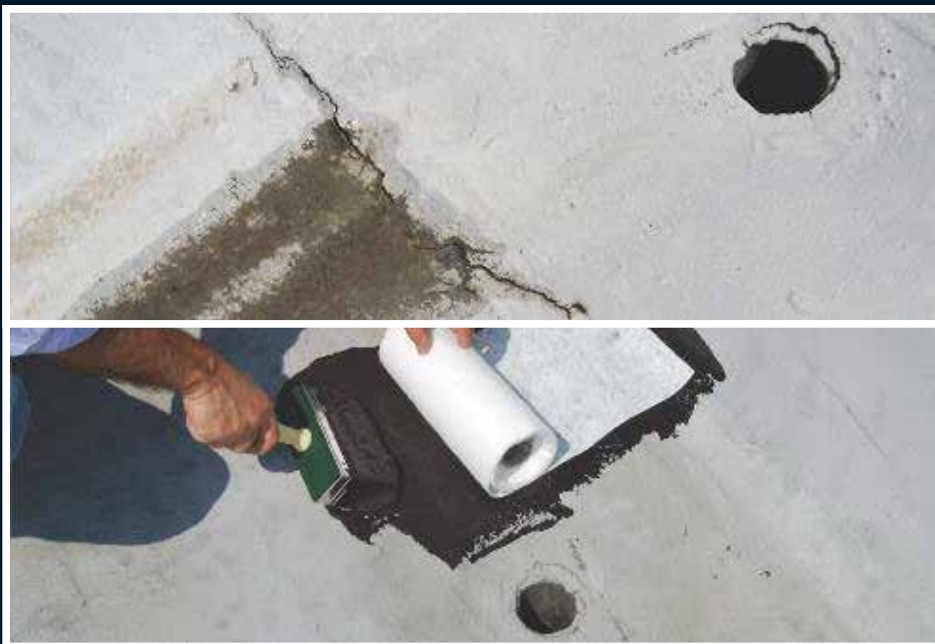
La riparazione impermeabile di fessure (nella foto si effettua la riparazione di una fessura su guaina bituminosa in prossimità del bocchettone di scarico usando ElastiK e Supporto Antifessura )
