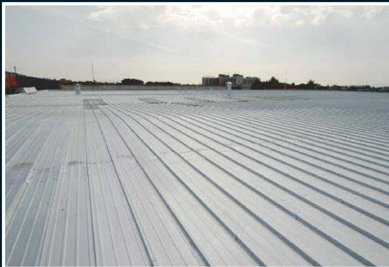
Aspetto della copertura metallica finita dopo il trattamento realizzato con una mano di vernice all'alluminio tipo Allumisol 12/14 steso dopo 20 giorni dalla seconda mano di ElastiK (applicazione a spruzzo con un consumo totale di 200 g/m 2 )
