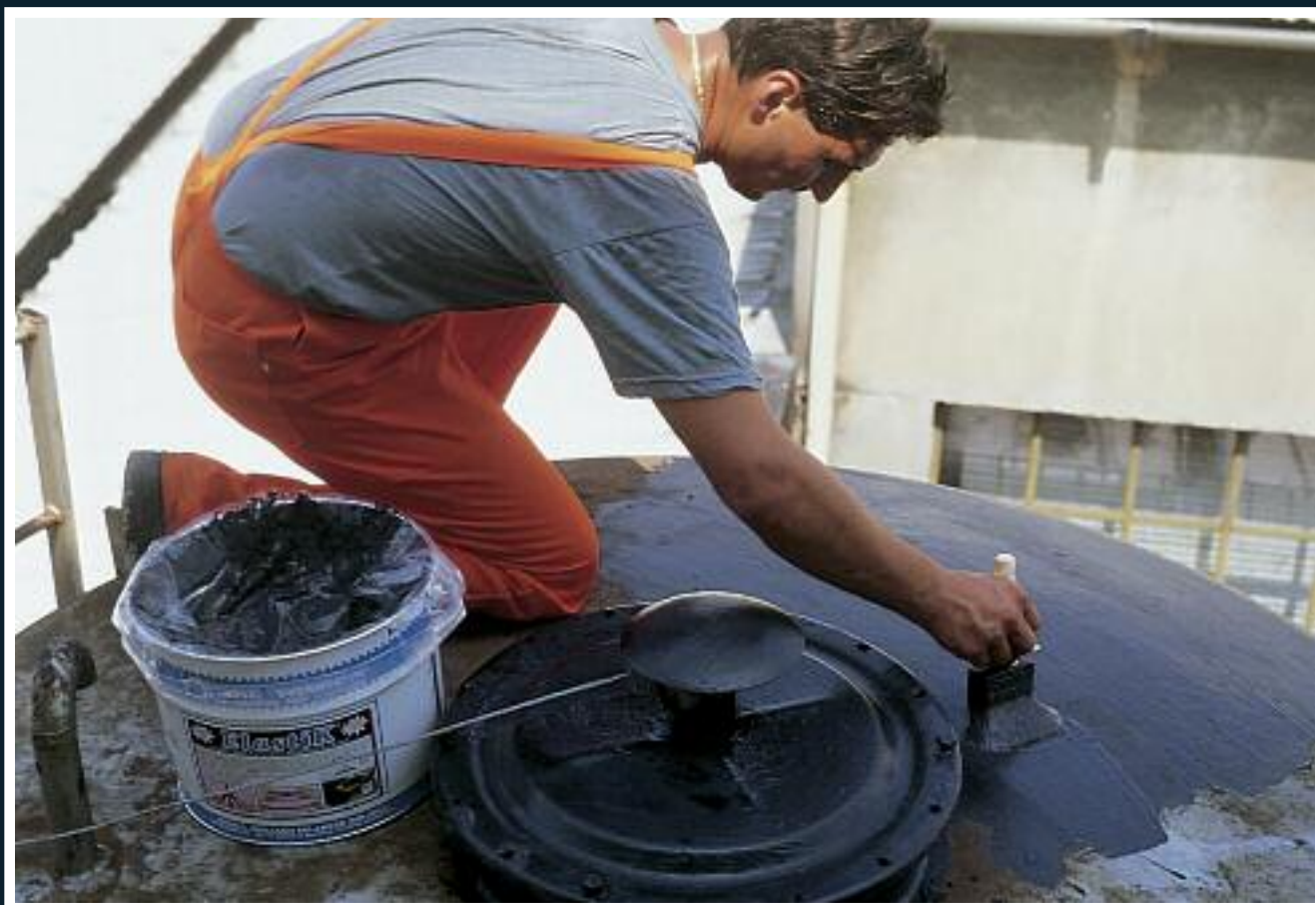
La protezione antiruggine ed impermeabile di tutte le superfici metalliche
